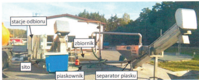
Rysunek 4. Punkt zlewny ścieków dowożonych [zdjęcie: PZJP]
