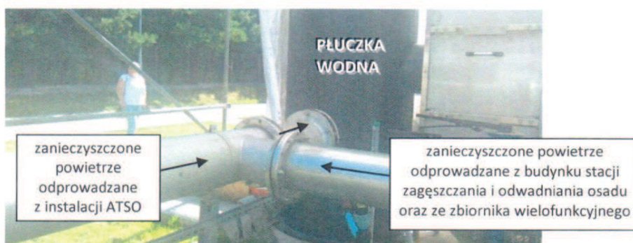
Rysunek 27. Wlot powietrza do instalacji dezodoryzującej nr 2 [zdjęcie: PZJP]
