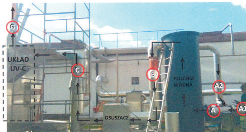
Rysunek 28. Lokalizacja punktów pomiarowych do oceny skuteczności instalacji dezodoryzującej nr 2 [zdjęcie: PZJP]
