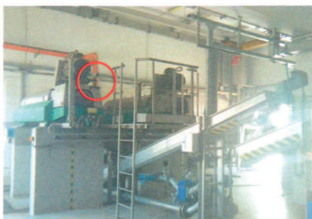
Rysunek 37. Budynek stacji zagęszczania i odwadniania osadu – przepustnica za wirówkami [zdjęcie: PZJP]
